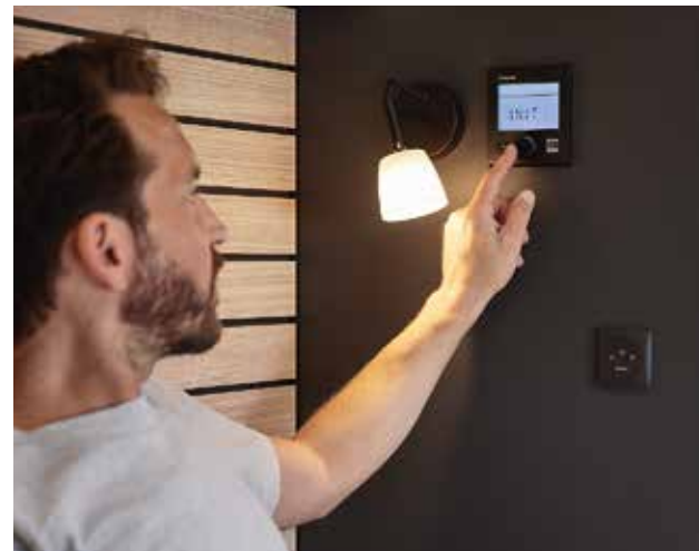
COMMANDE DES LUMIÈRES ET DU CHAUFFAGE DANS L'ESPACE COUCHAGE
